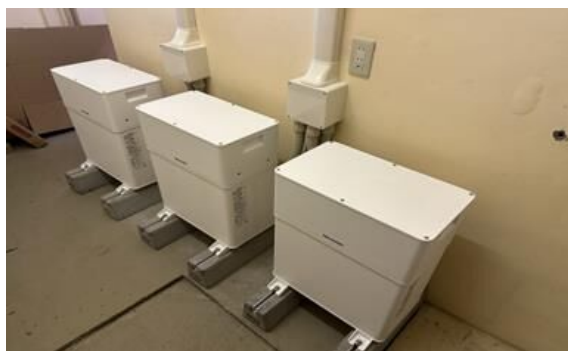
▲蓄電システム
