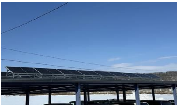
▲太陽光発電設備
