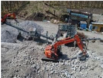
▲コンクリート破碎施設
