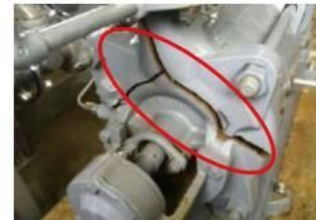
揚水機のモーター破損
