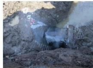
パイプラインの破損
