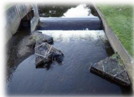
損壊した魚道
